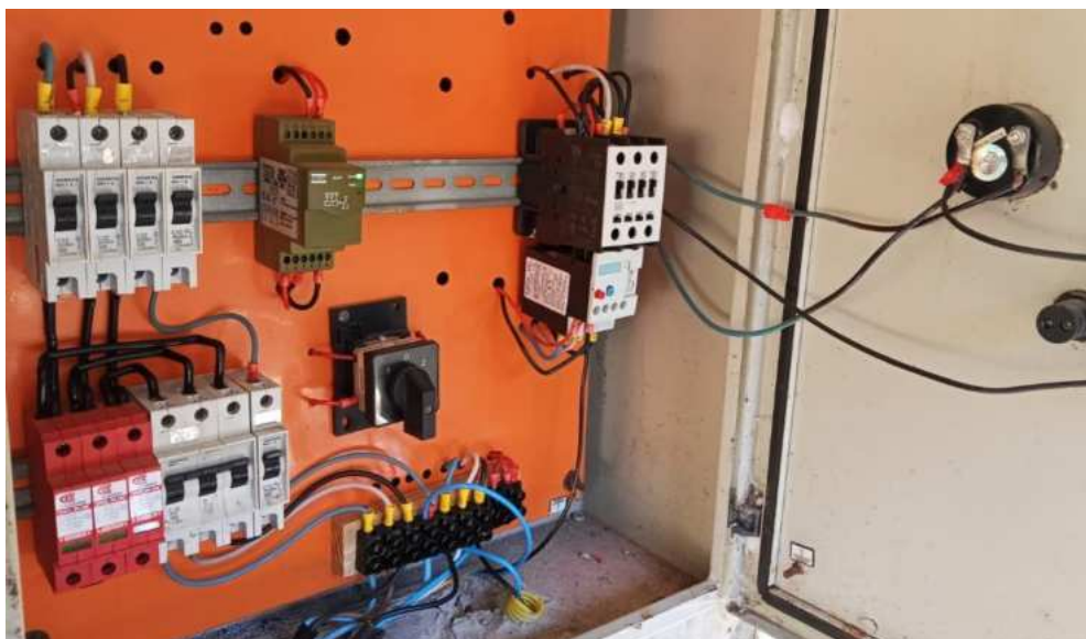
Figura 2 - Cabo derretendo, com cobre exposto.
