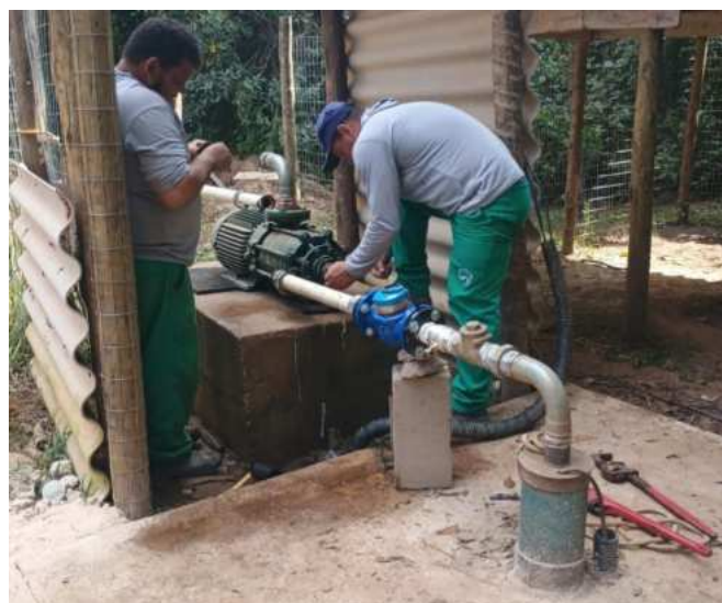
Figura 4 - Bomba centrífuga, situação existente.
