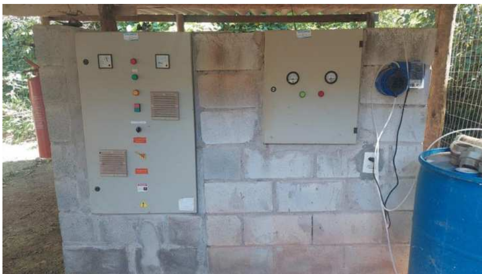
Figura 1 - Quadros das bombas do poço da quadra 14.
